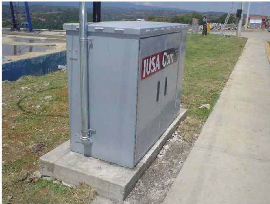
Gabinete para servicios de televisión por cable.
