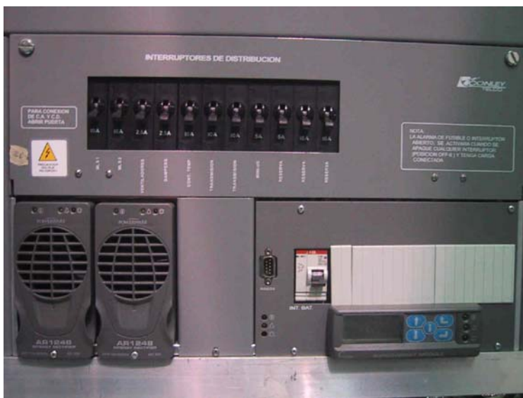
Planta de fuerza CD Conley con dos rectificadores
