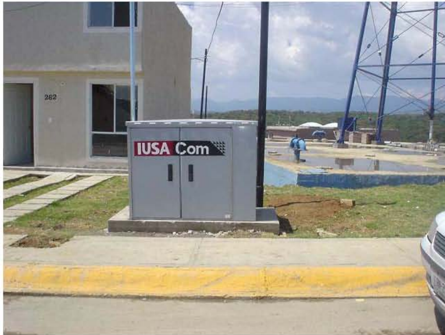
Gabinete para servicios de Televisión por cable y DSL
