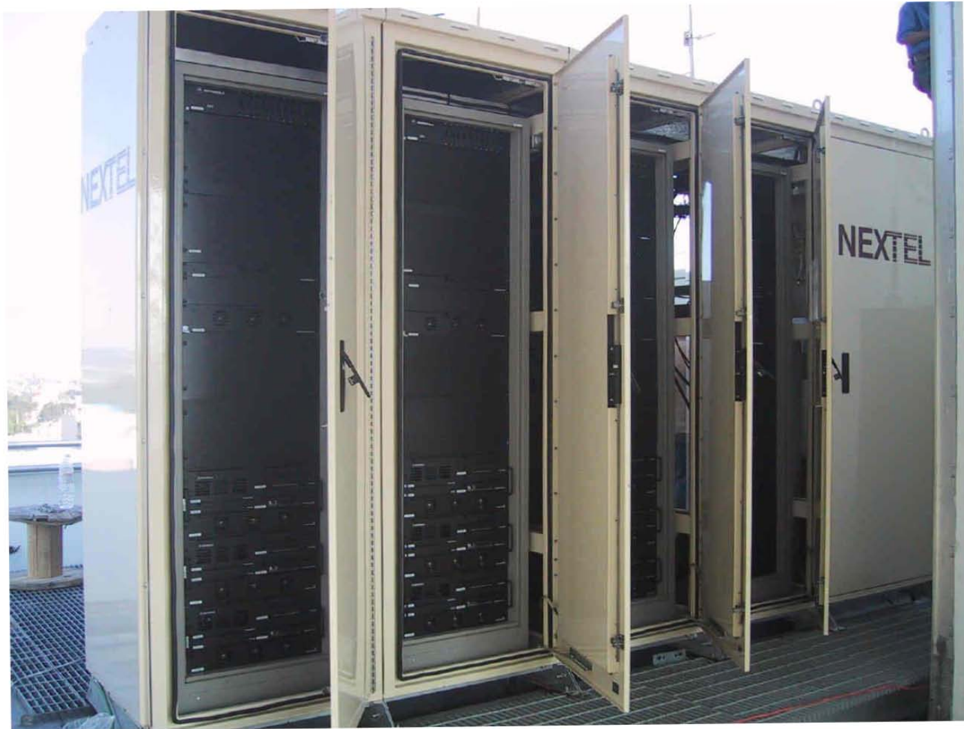
Vista frontal de acceso a equipos Motorola IDEN de RF y control.
