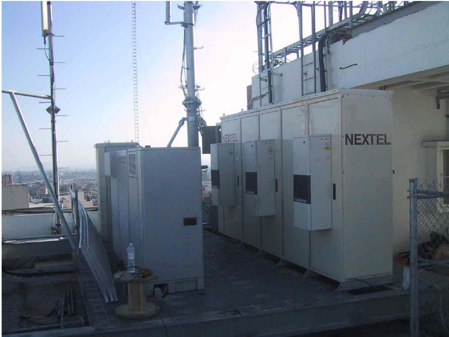
Vista panorámica del gabinete modular instalado en sitio. Se puede observar que el espacio en pasillos es suficiente para acceso por ambos lados.
