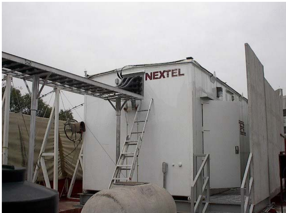
Cama de líneas (feeders) desde contenedor hacia antenas en torre.
