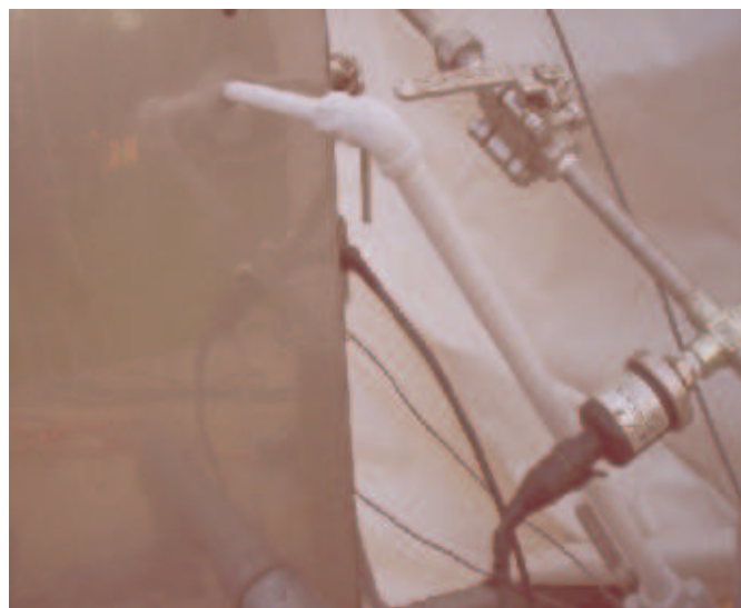
Fig. 6.40 Formación de escarcha en la tubería a la salida del evaporador
