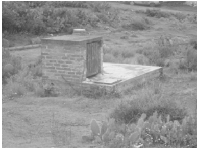
Foto 16. Cisterna acometida de agua.
