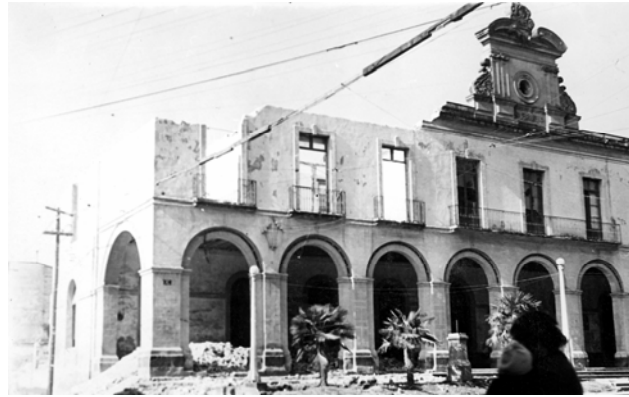
1952. Obras de demolición del Antiguo Palacio Municipal para la ampliación de la Av. Revolución
