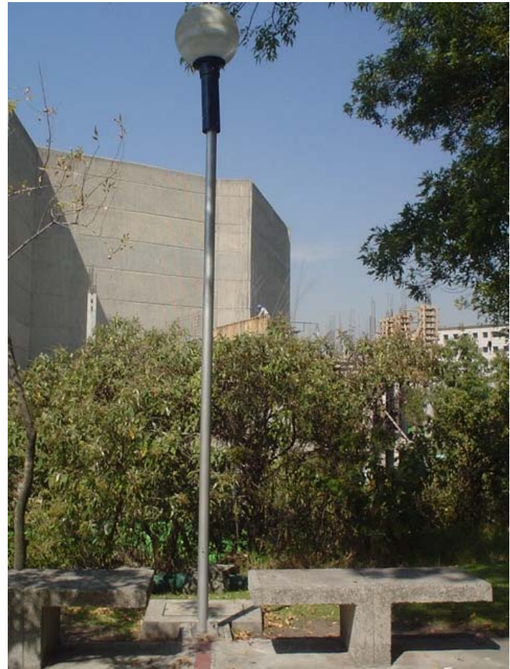
Poste de luz en andadores.
