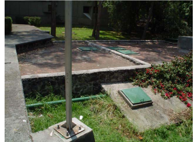
Agua Potable Aunque se tiene el servicio continuo de bombeo se recomienda Cisterna para garantizar el abastecimiento de agua.
