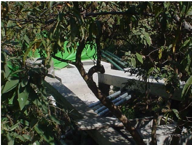
Pasos de tubería interna
