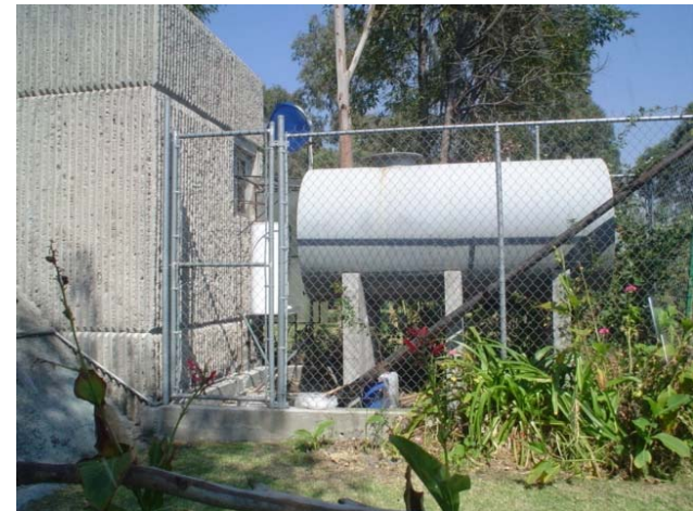
Parte de la subestación eléctrica
