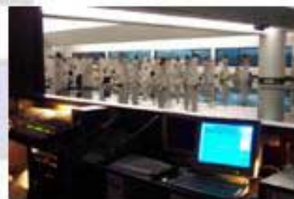
Cuarto de control
