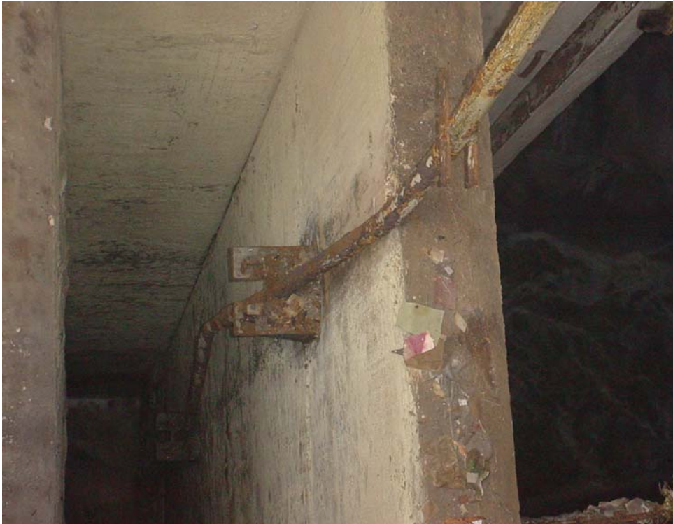
Foto 7 Daños en los mecanismos de operación
