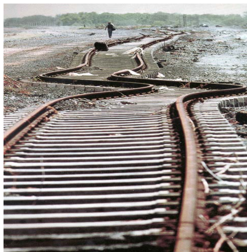
Figura 3 Deformación permanente de una vía férrea ocurrida en México durante el sismo de 1985
