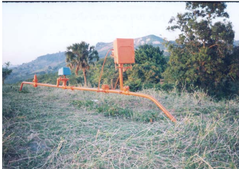
Fig. 3.18 Conexiones Superficiales para Inyección de Gas
