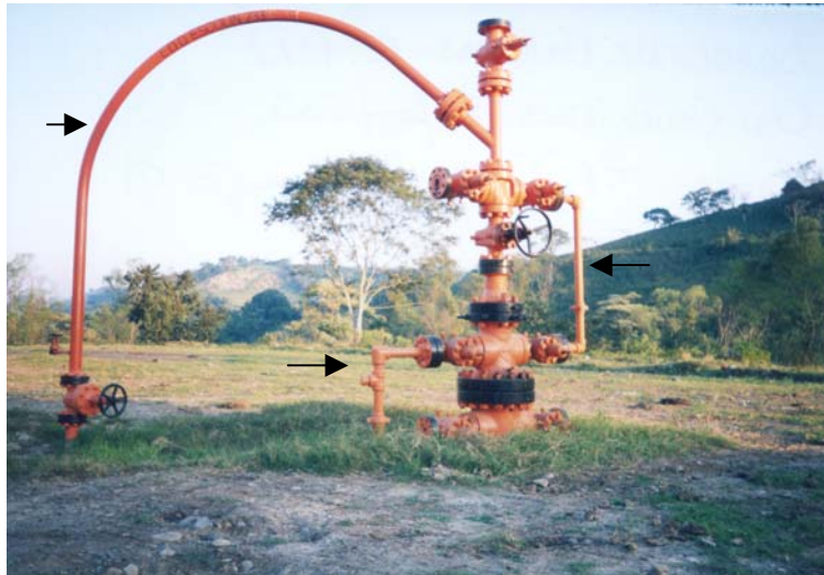
Fig. 3.17 Garza: Conexiones Superficiales de Descarga del Pozo
