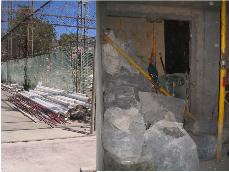
Figura 37. Incremento en el inventario de materiales fuera de los almacenes en un desarrollo de Michoacán, que no será utilizada en los siguientes semanas. En la izquierda tubería de PVC, afectada por el sol. A la derecha, inventario excesivo de separadores de cimbra. (Fuente: propia)
