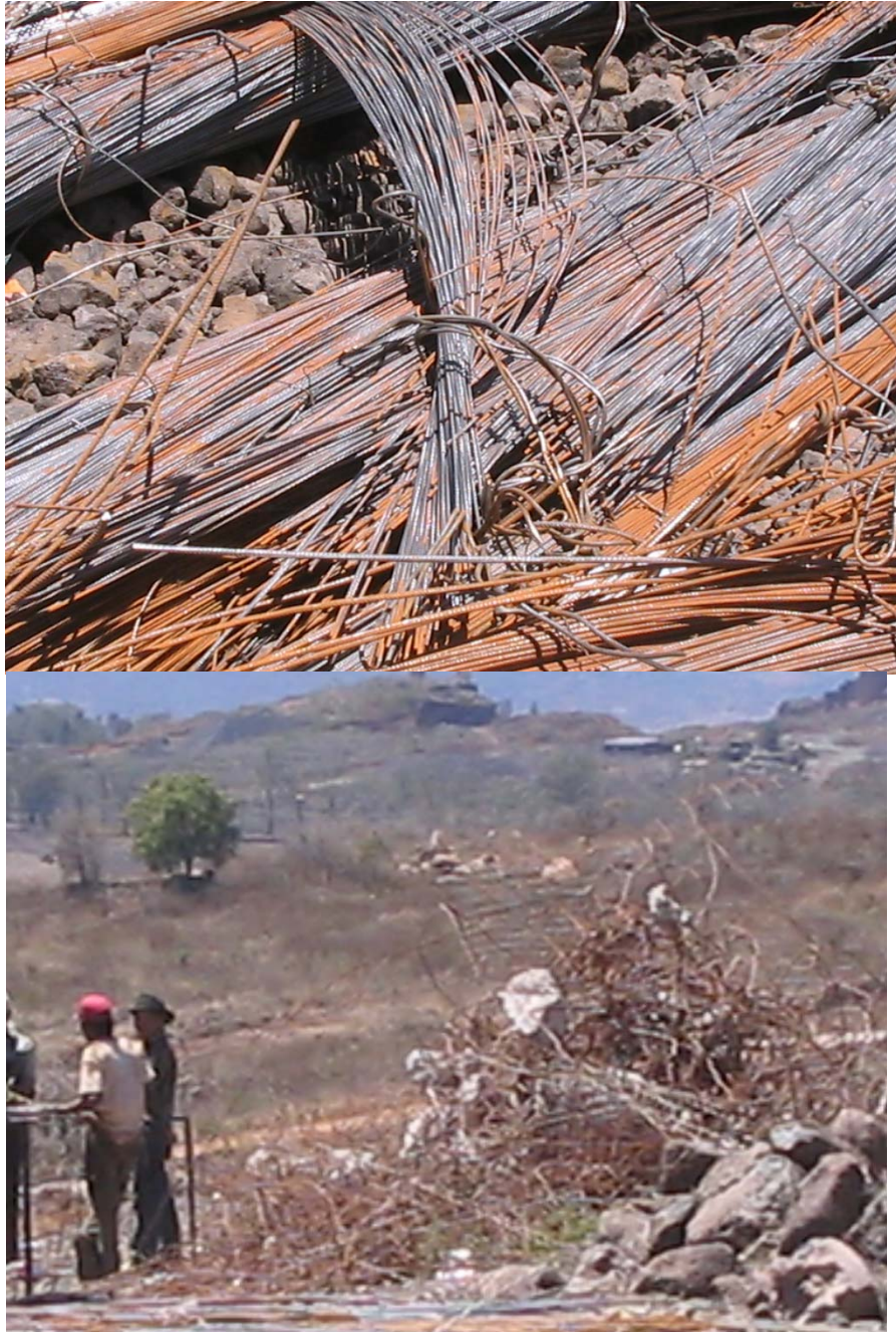
Figura 39. Daño en las estibas de varillas de acero derivado de la falta de equipo y de la inadecuada operación de descarga en los almacenes. (Fuente:propia)
