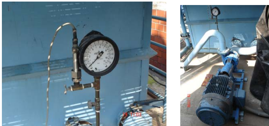
Fig. 2.10. Presión en la descarga de la bomba.
