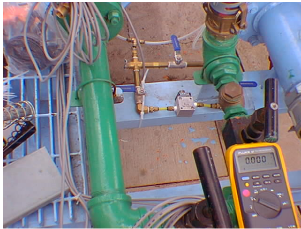
Fig. 2.30. Colocación del sensor de presión diferencial en la sección de gas.
