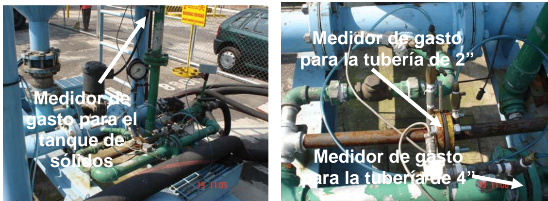
Fig. 2.29. Medidores de gasto en la sección de gas.
