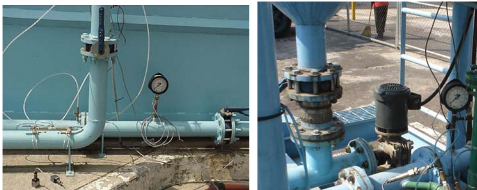
Fig. 2.11. Sensores para medir la pérdida de carga.
