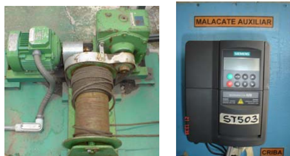
Fig. 2.46. Inversor del motor del malacate secundario.
