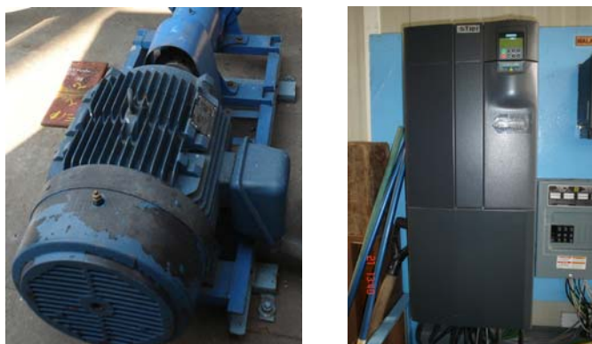
Fig. 2.43. Motor e inversor de la bomba.
