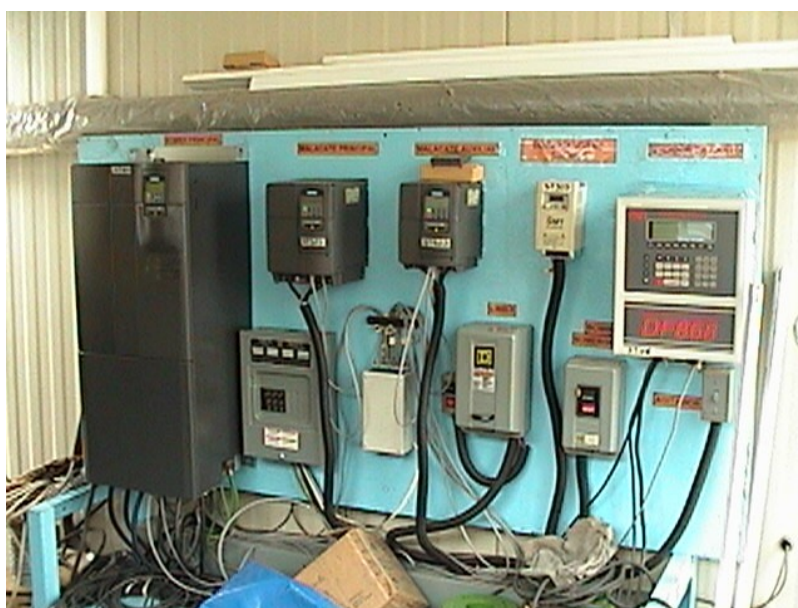
Fig. 2.42. Panel de potencia.
