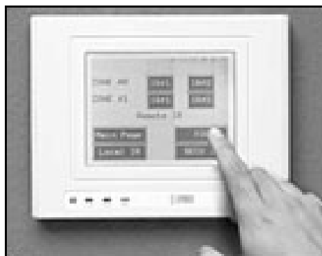
Figura 1.5.2. -Equipo de control central en una casa habitación
