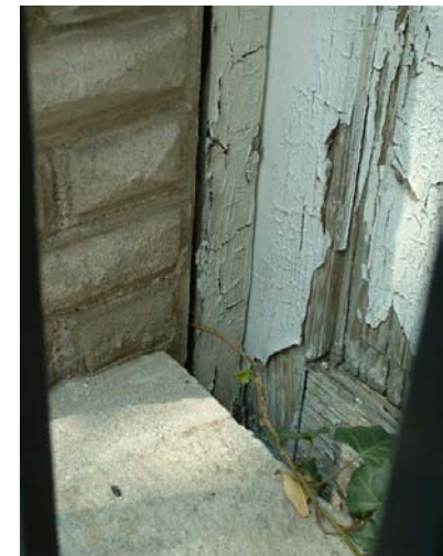
Vegetación parásita en ventanas
