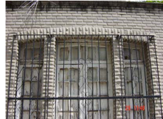
Humedad en la parte superior de la fachada
