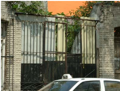
Derrumbe del cerramiento de la puerta
