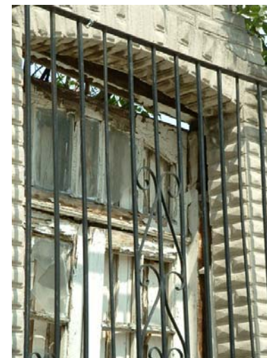
Manguetería de madera dañada
