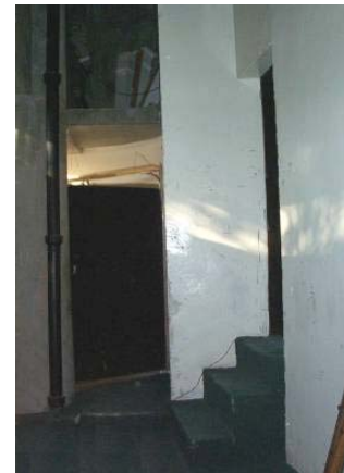
Salida de emergencia.
