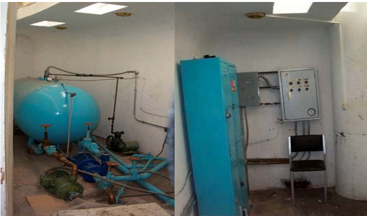
Cuarto de máquinas y tablero de energía.
