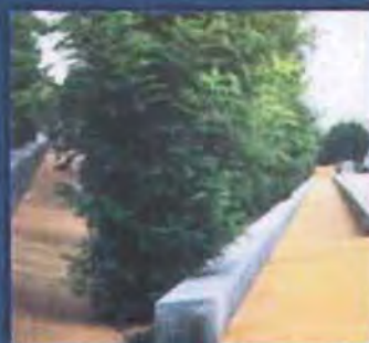
SANEAMIENTO DE LA VEGETACIÓN EN EL CAMELLÓN Y EN LAS CALLES
