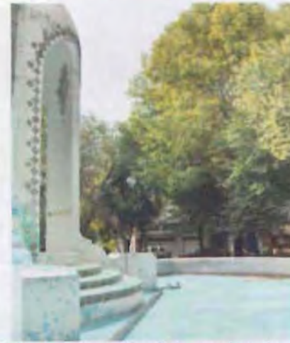
Foto 93. Glorieta de Popocatépetl, los pavimentos están rotos por la acción de las raíces, la fuente se encuentra en un mediano nivel de conservación a pesar que a igual que las demás no tiene el cuidado adecuado.
