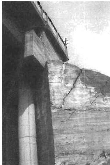
Fig. 3.4 Grietas en el estribo norte
