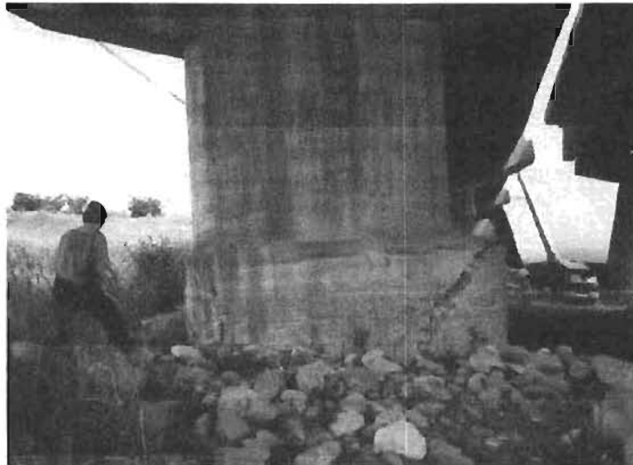
Fig. 3.1 Falla por cortante
