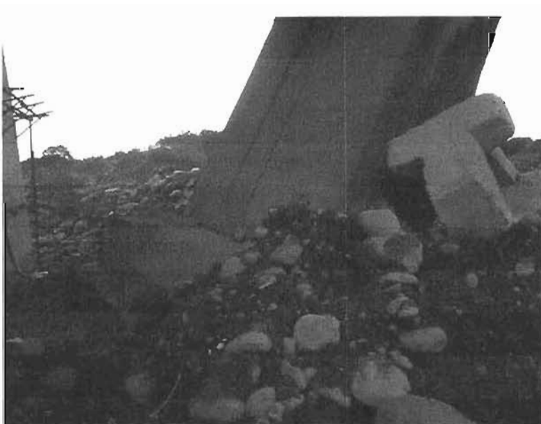
Fig. 3.18 Falla por cortante en cimentación
