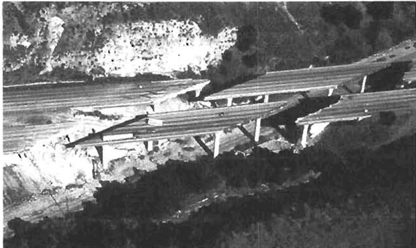
Fig. 3.7 Daños observados en el puente
