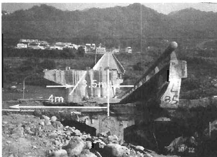
Fig. 3.16 Desplazamientos laterales en el puente
