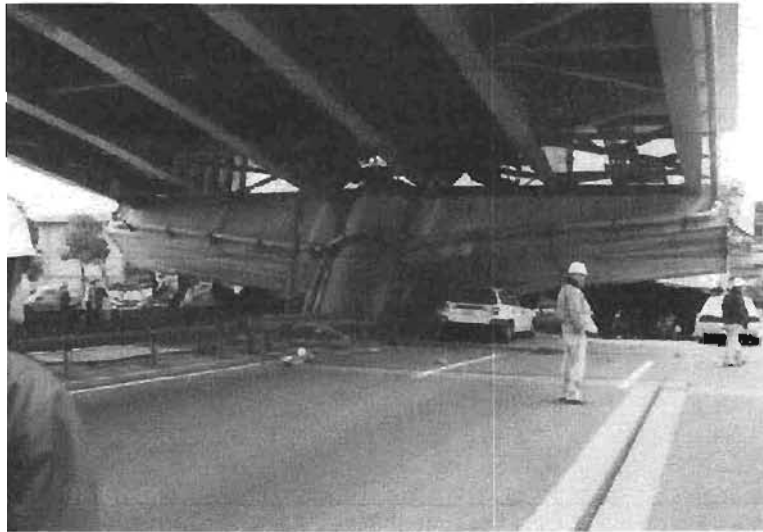
Fig. 3.13 Colapso de columna de concreto del viaducto Hashin
