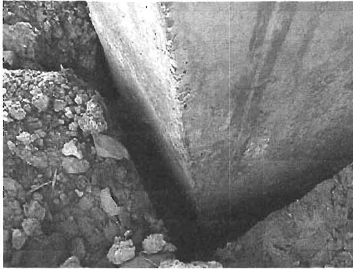
Fig. 3.22 Desplazamientos observados en base de columna
