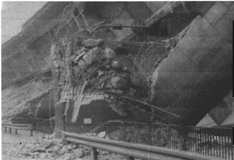
Fig. 3.12 Falla prematura por cortante en columna
