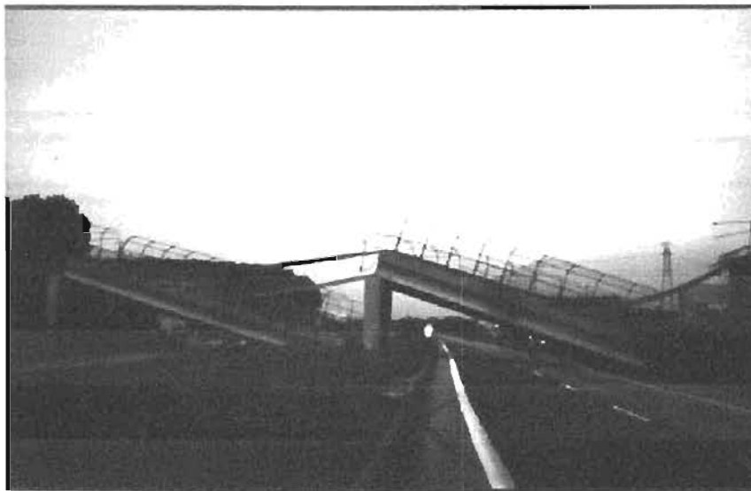
Fig. 3.15 Colapso del puente Arifive
