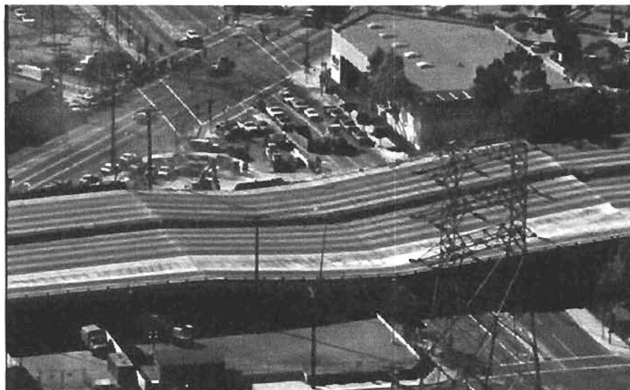
Fig. 3.10 Desplome sobre estacionamientos del puente Cienega - Venie
