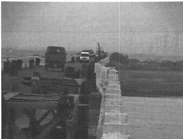
Fig. 3.23 Desplazamientos observados en el puente
