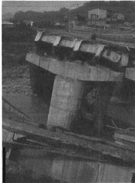
Fig. 3.17 Daños en la parte sur del puente
