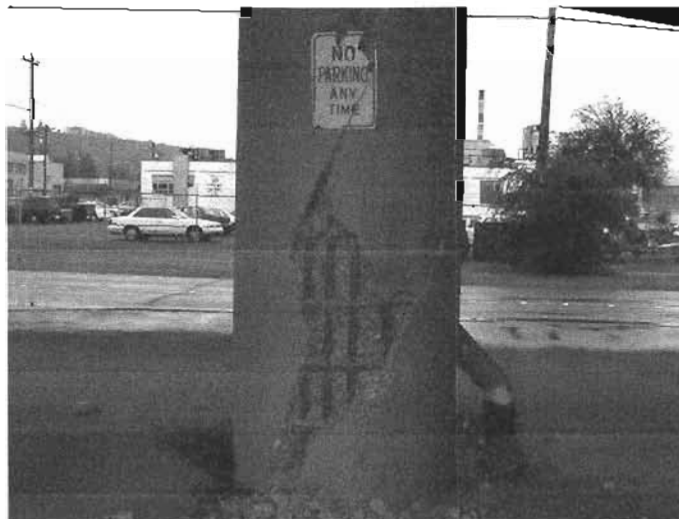
Fig. 3.25 Grietas en columnas
