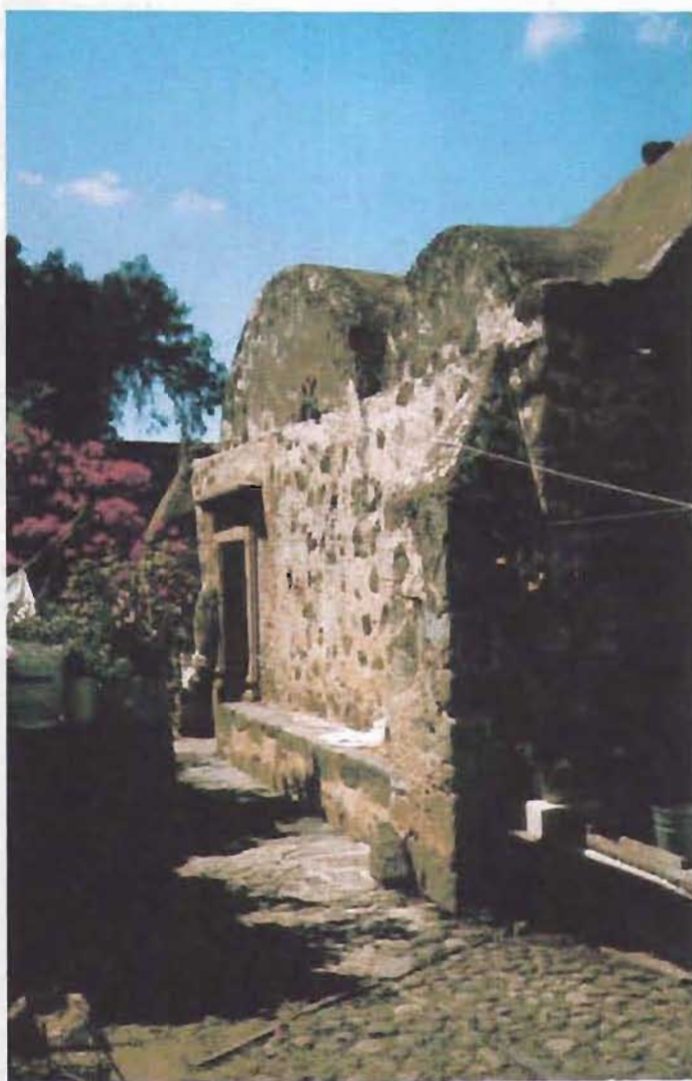
Fig. 70. Oratorio doméstico cubierto con dos bóvedas: una de lunetos con cúpula; y otra de aristas. Nopala, Hidalgo. Foto: RPM.
