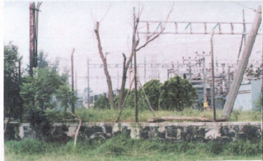
Unidad de Transferencia de Energía Eléctrica
