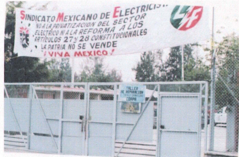
Zona de Transformadores de la Unidad de Transferencia
