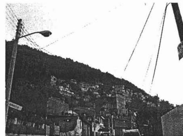
74. Fotos de la Red secundaria de alumbrado Público, Zona de estudio, Cerro del Judío, Delegación Magdalena Contreras.
