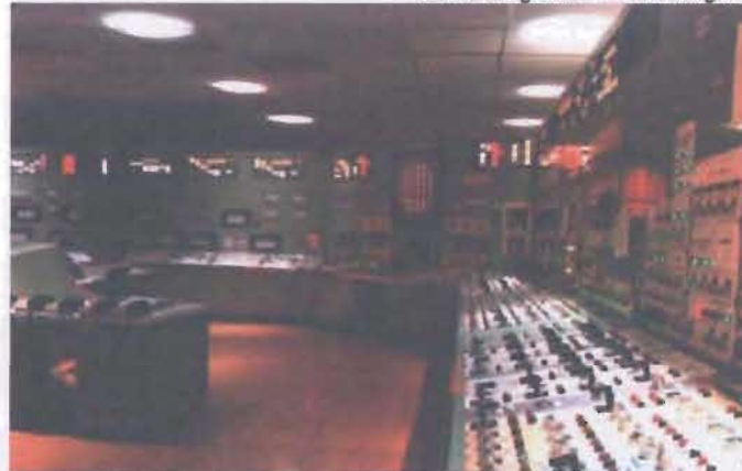
Imagen (5) sala de control de una central nucleoelectrónica
