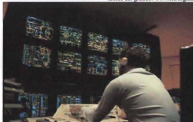
Imagen (3) un operador frente al panel de control.
