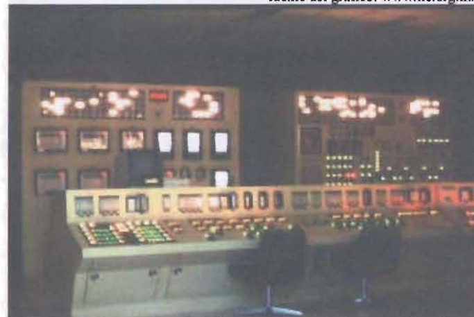
Imagen (8) sala de control de una central termoeléctrica
