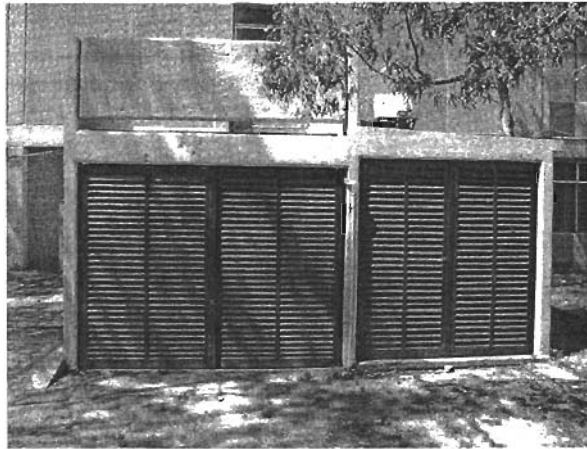
Fig. 6.6 Subestación del edificio del centro de cómputo y anexos.
