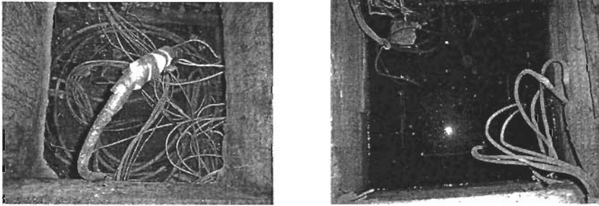
Fig. 6.7 Registros eléctricos con problemas de inundación.
