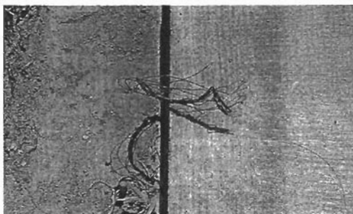
Fig. 6.14. Sistema de tierra para pararrayos, fueron cortados.
