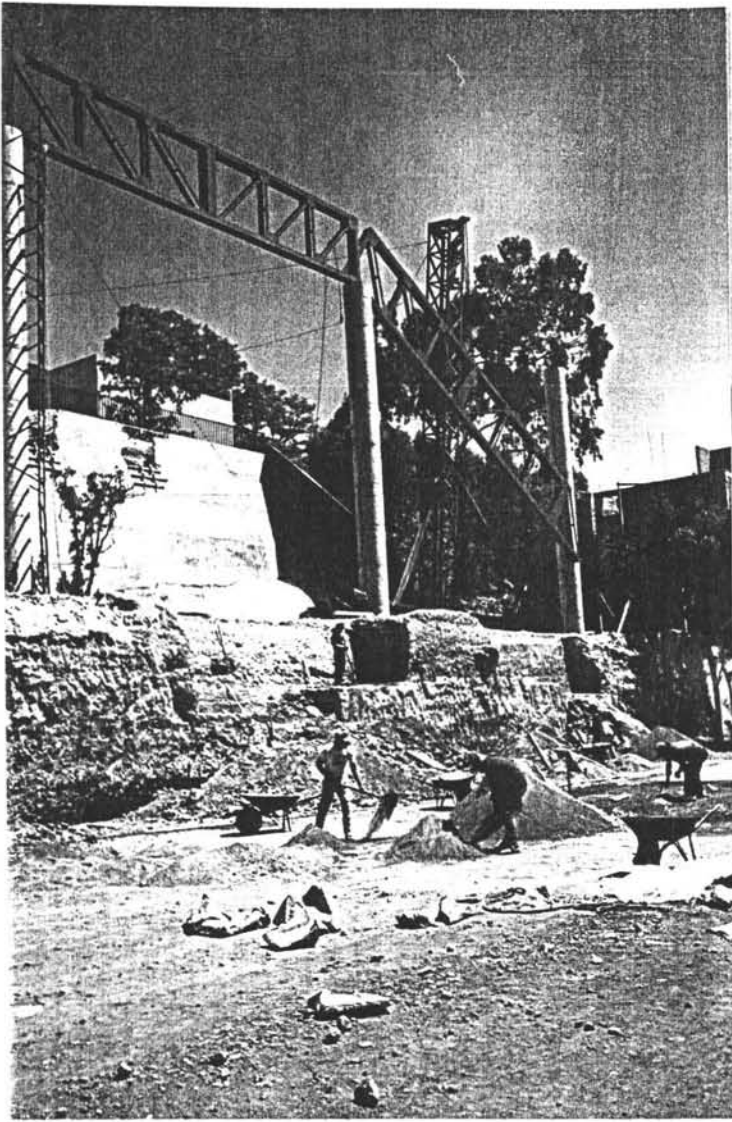
Fig. I.1.3. Montaje de la estructura metálica en la construcción de la cancha de tenis 2.
