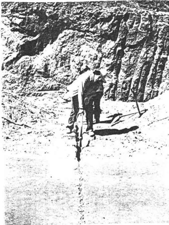
Fig. 5.4.4. Proceso de abrir caja en la capa de Suelo-Cemento para la Junta de Dilatación.
