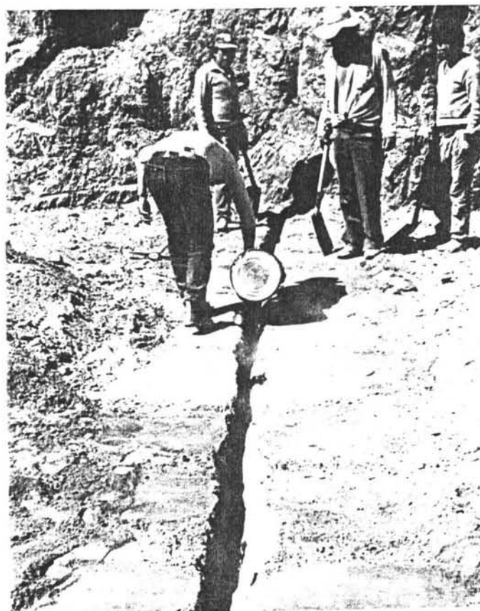
Fig. 5.4.5. Proceso de colocar asfalto líquido en la capa de Suelo-Cemento para la Junta de Dilatación.
