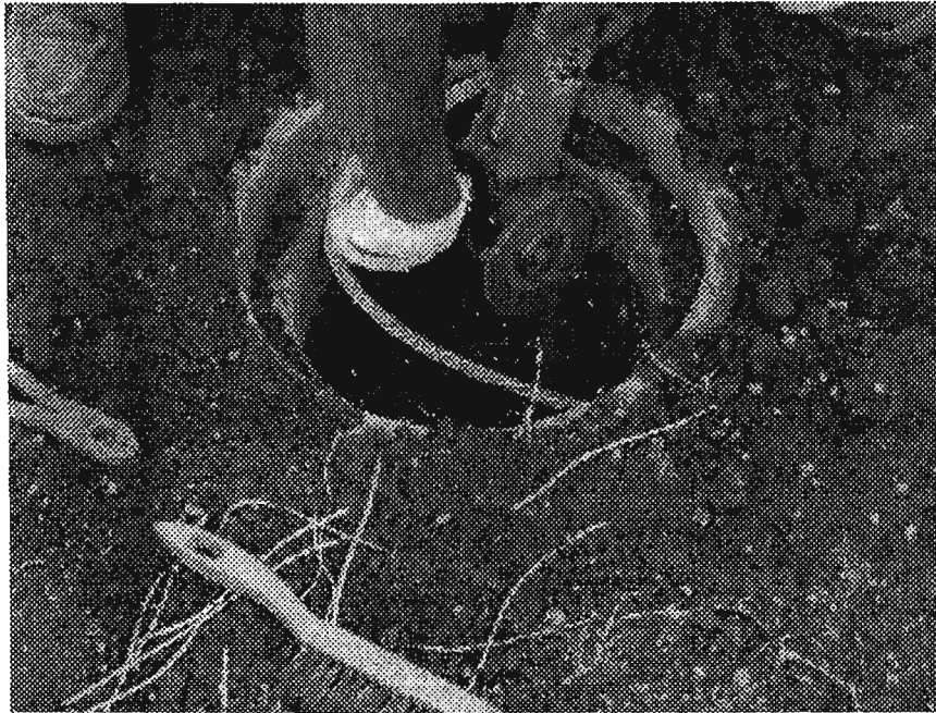
Figura.5.27. Corrección de la deformación del electrodo de puesta a tierra.
