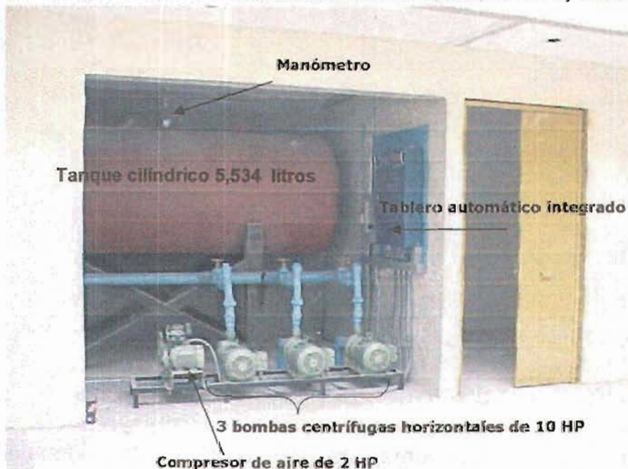
Fotografía 18. Equipo hidroneumático del condominio II.
