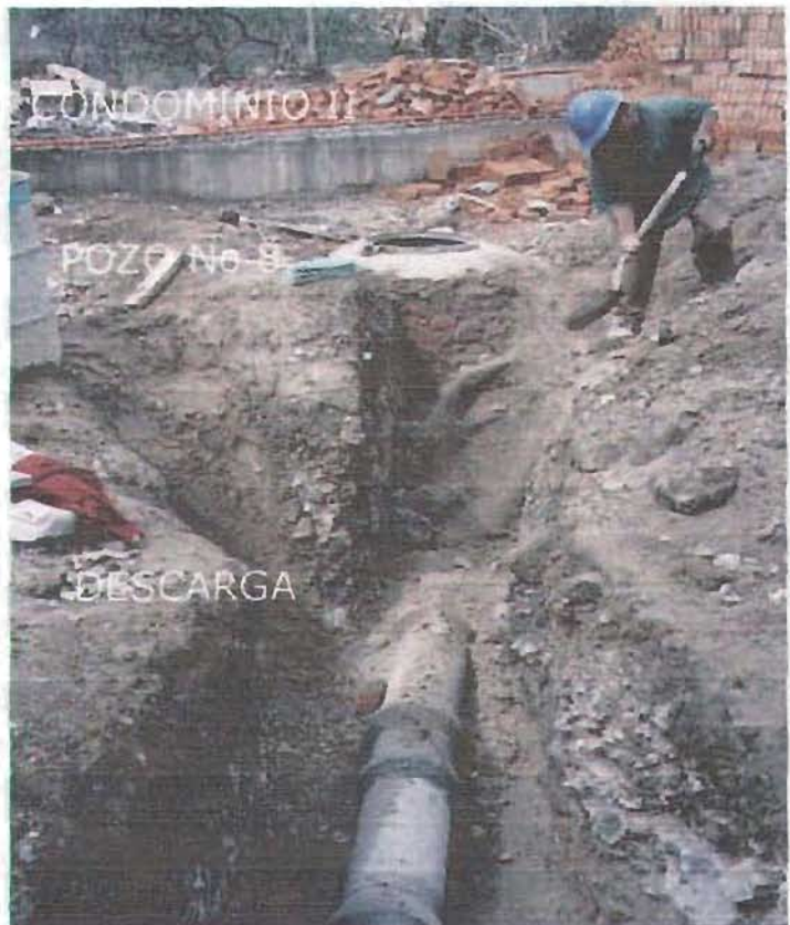
Fotografía 17. Conexión de descarga domiciliaria, directamente en pozo de visita.
