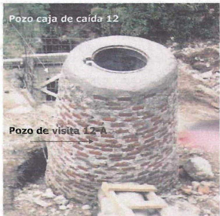
Fotografía 16. Pozo de visita 12-A y caja de caída 12 de la red pluvial del condominio I.
