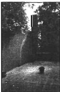
Foto 15 Vista desde el Privado 2 hacia el exterior, donde se ve la terraza 2, muro en mal estado, vegetación como remate y macetas ubicadas sin un arreglo espacial.
