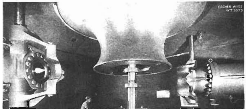
Figura 5.5. Vista de dos pares de cangilones usadas en las turbinas 1, 2, 9 y 10 de la planta oberthasi (suiza)
