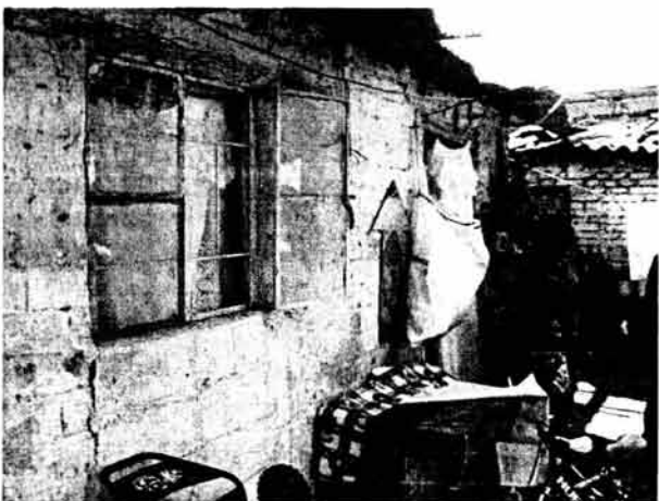
Vivienda en alto grado de deterioro
