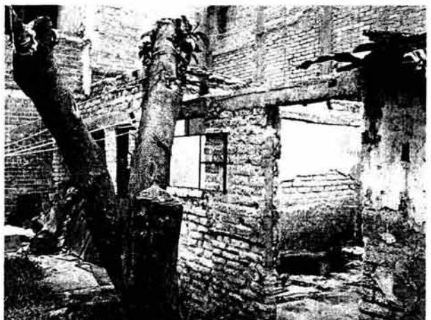
Vivienda deshabitada por derrumbe
