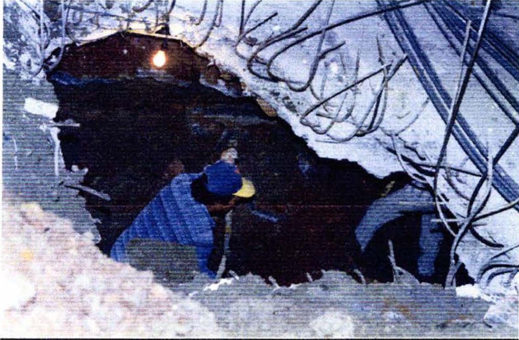
Fig No. 36 Demolición de losa de cimentación y excavación en terreno natural
