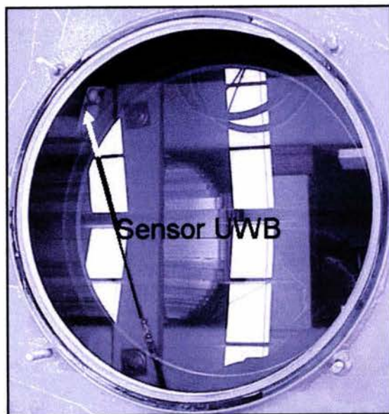
Fig. 4-3. Ubicación de los sensores en el yugo del transformador. Ubicación del sensor 2 a través del registro hombre.
