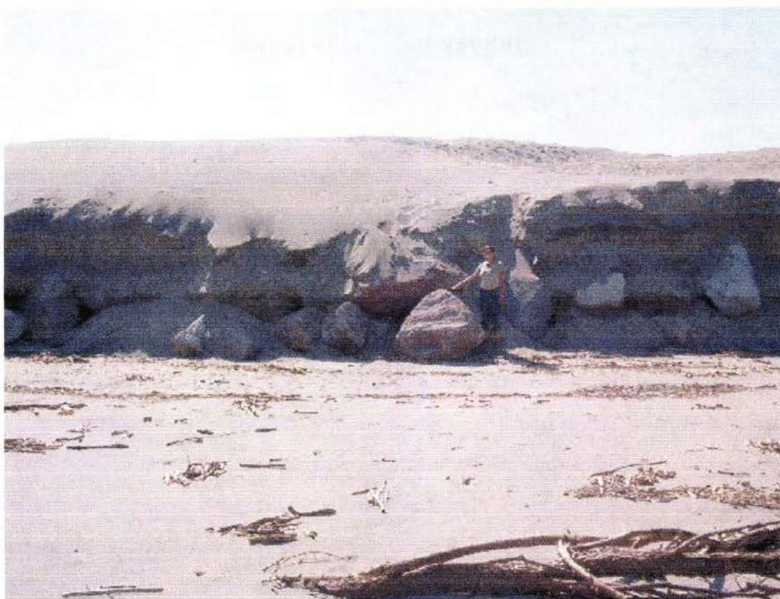
Fig. 15 Vista de la escollera rebasada por el azolve del Río Baiuarte
