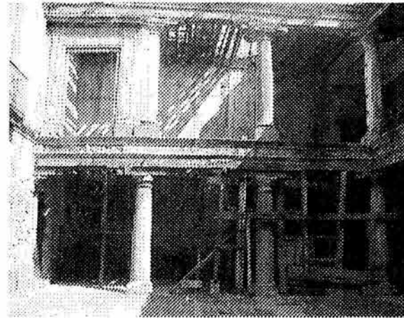
7. Crujía norte del patio principal, no tiene la techumbre de la azotea, y el entrepiso del primer nivel está incompleto.
