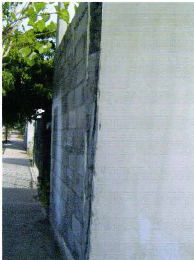
Foto 6.4 Desplome de bardas
