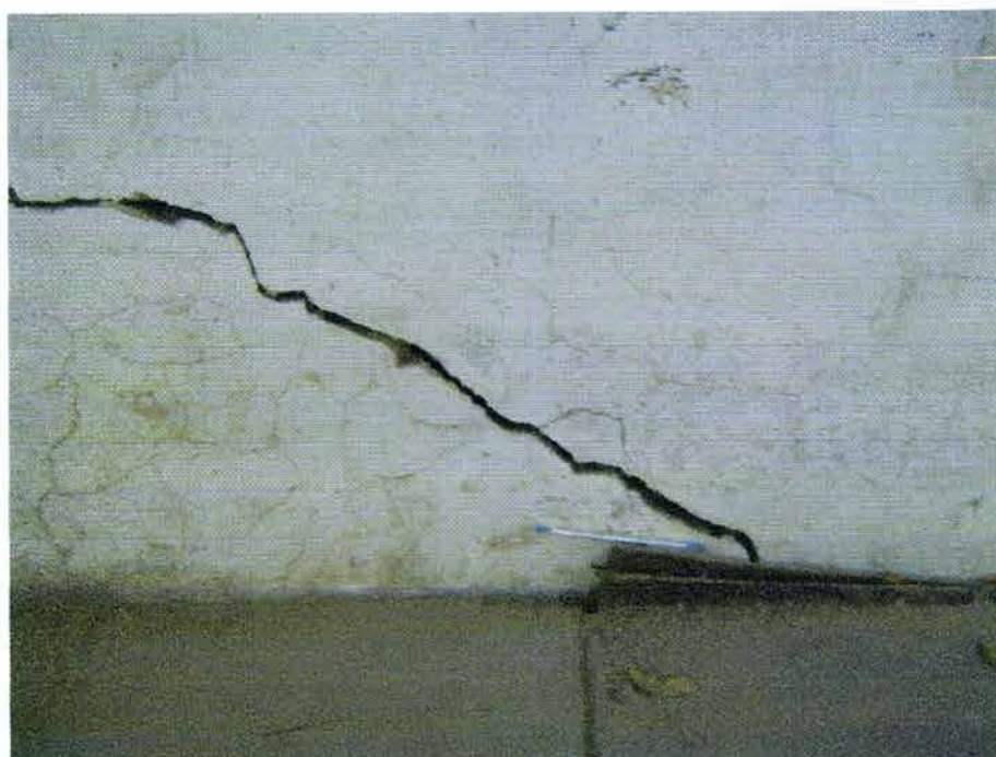
Foto 6.1 Falla (grieta inclinada) por asentamiento diferencial
