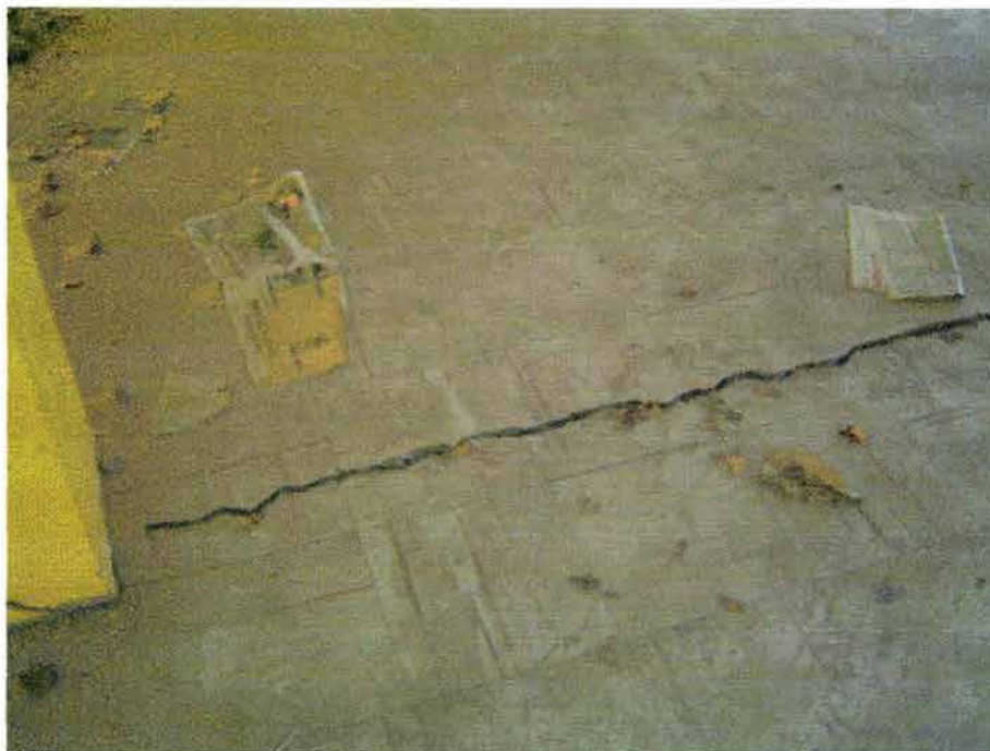
Foto 6.2 Falla por asentamiento (hundimiento de piso)
