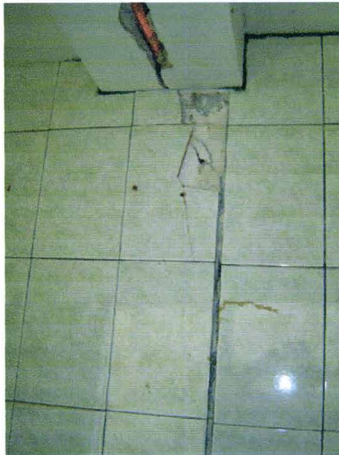
Foto 6.7 Desprendimiento de recubrimientos (azulejos)
