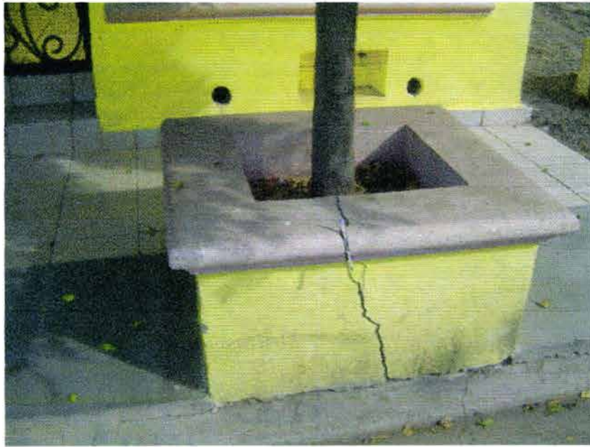
Foto 6.6 Agrietamiento de jardineras
