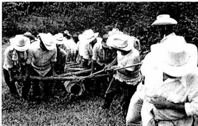
Faena para la instalación de la luz eléctrica en Chicueyaco. Foto: MC.
