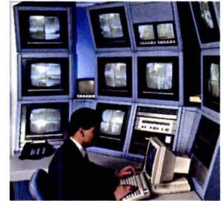
Cuarto de control central
