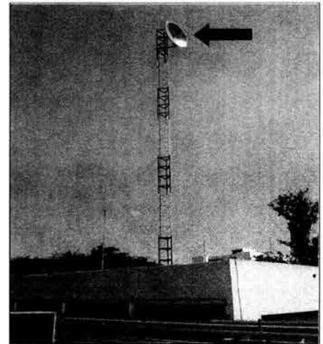
Torre en la que se encuentra instalada antena con dirección al punto A
