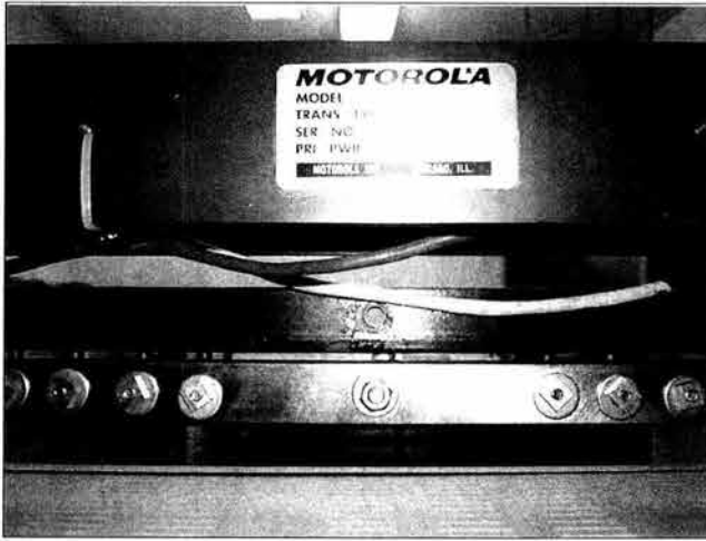
Barra de Tierra donde se aterriza el radio en el Bastidor
