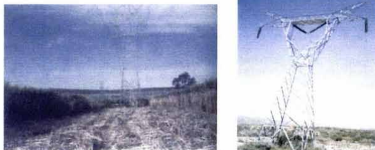
Figura 3 Corte de caña en verde bajo líneas de 400 kV antes de la quema de parcela e instalación de bandas de protección del aislamiento contra contaminación por excremento de aves para evitar salidas de la línea.
