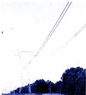
Figura 4.1 Conductores empleados en líneas de transmisión.
