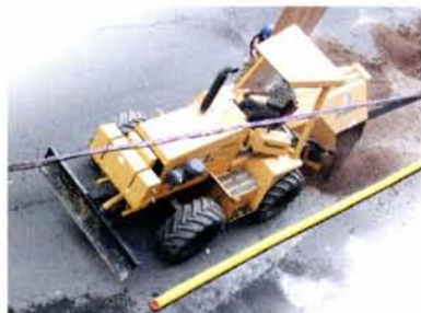
Fig. 6.6 Los equipos de excavación son amarillos para que resalten contra pavimentos y follajes. Amarillo es el código para las tuberías de gas.
