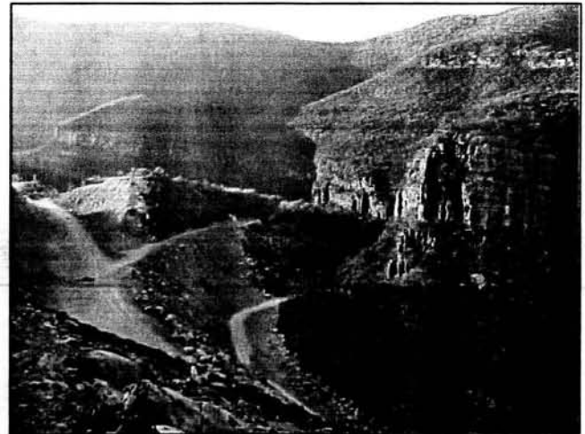
52.- PANORÁMICA TOMADA EN LOS RECORRIDOS GEOTÉCNICOS, EN DONDE SE MUESTRAN LOS AVANCES DE LA CARRETERA
