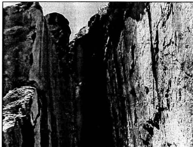
62.- SEPARACIÓN DE LOS BLOQUES DESLIZADOS DEL TALUD ANTERIOR
