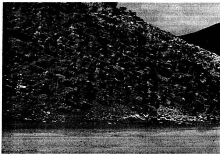
Fig. 2.1.a Discontinuidades paralelas al echado del talud.
