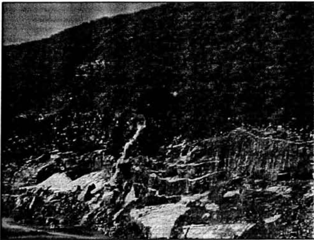
59.- INICIO DE LA VOLADURA DE PRUEBA EN LA ZONA EN ESTUDIO, PARA LA ESTABILIDAD DE LOS CORTES.
