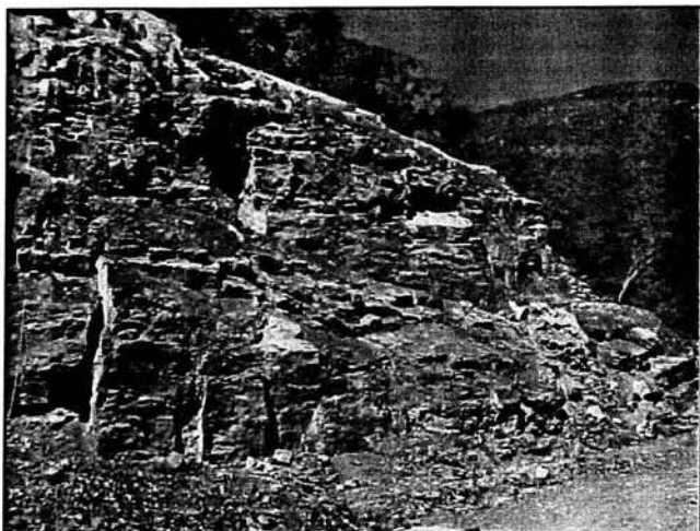
61.- TALUD QUE PRESENTA DOS PLANOS POTENCIALES DE DESLIZAMIENTO
