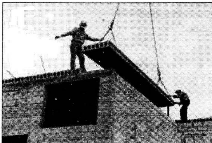
Figura 2.2 Se muestra en la gráfica el montaje de las piezas prefabricadas, los paneles de concreto son ubicados en planos y posteriormente colocados en su sitio definitivo con ayuda de grúa.
