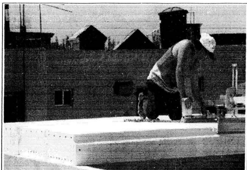
Figura 4.17 En la fotografía se muestra la colocación de paneles consecutivos, apoyados sobre muros de bloque de concreto celular.
