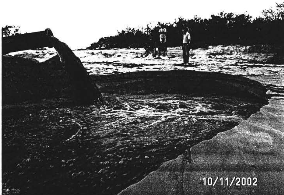
Foto 5.26 Disminución de velocidad de descarga debido al taponamiento de succión en la draga ocasionado por el sargazo.
