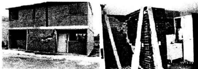
Figura 6.2 Daño severo en una vivienda después de sismo en Cd. Serdán Pue. Se puede observar daño en los muros interiores de la vivienda.
