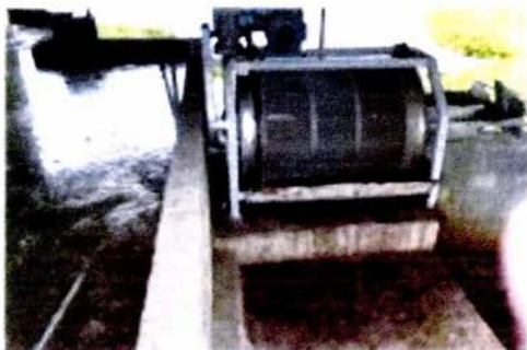
Figura 13. Separador de sólidos de tipo cilíndrico.
