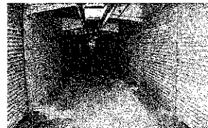
Pasillo comercial en estado residual
