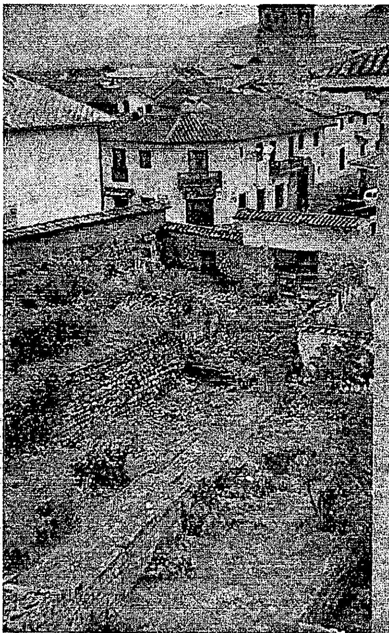
Fotografía del objeto de estudio, interior de la esquina de la calle de Afligidos y el callejón de Loreto, donde se aprecia la existencia de restos de medios muros y cimentación de la etapa inca (prehispánico) el estado de abandono y ruinoso que se encuentra, cubierto en su mayoría por arbustos y vegetación. (Fotografía del Autor. 1993)
