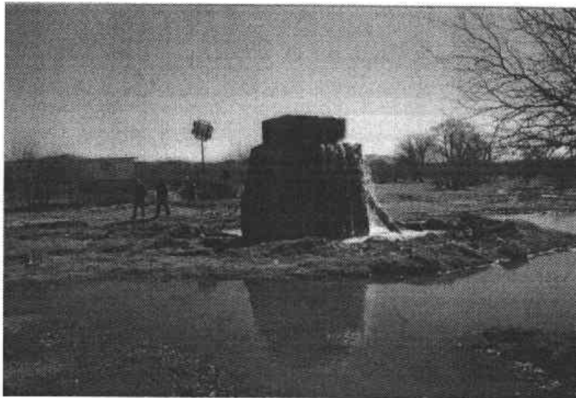
Figura 2.14 Registro donde Descargaba la Noria II
