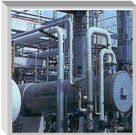
FIG. 1.12 INTERCAMBIADOR DE CALOR EN CAMPO (PLANTA HDR. REFINERÍA M. AMOR. SALAMANCA GTO.)
