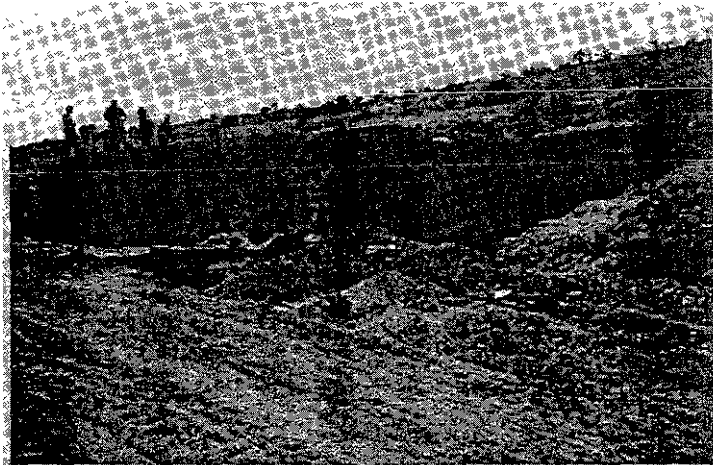
TANQUE SUPERFICIAL DE 40 M 3 DE CAPACIDAD
