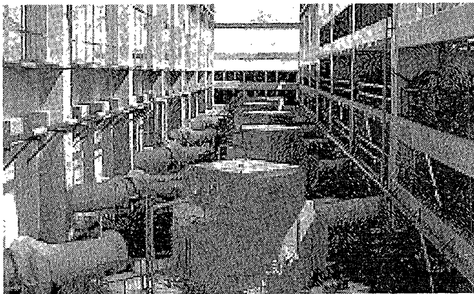
Equipos de la planta de bombeo No. 5
