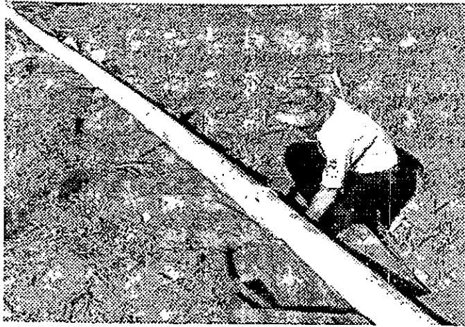
Fotografía 3- 7 Cambio del grupo de compuertas por regar
