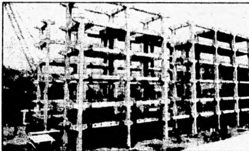
ESTRUCTURA DEL EDIFICIO DEL COLEGIO DE INGENIEROS CIVILES PARA OFICINAS; APLICACION DE ELEMENTOS PREFABRICADOS.
